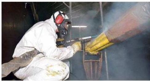
Gut geschützt durch seine Montur verschießt Matthias Petzoldt Trockeneispellets auf die Tragkabel der Mettlacher Brücke.
